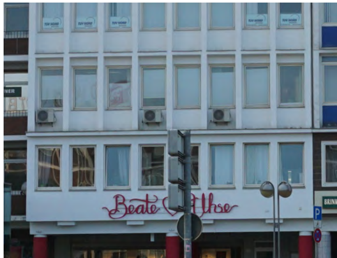
Abb. 210: haustechnische Anlagen ohne Integration in Fassadengestaltung
