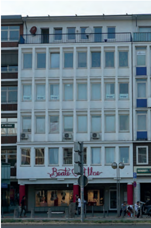
Abb. 83: haustechnische Anlagen ohne Integration in Fassadengestaltung
