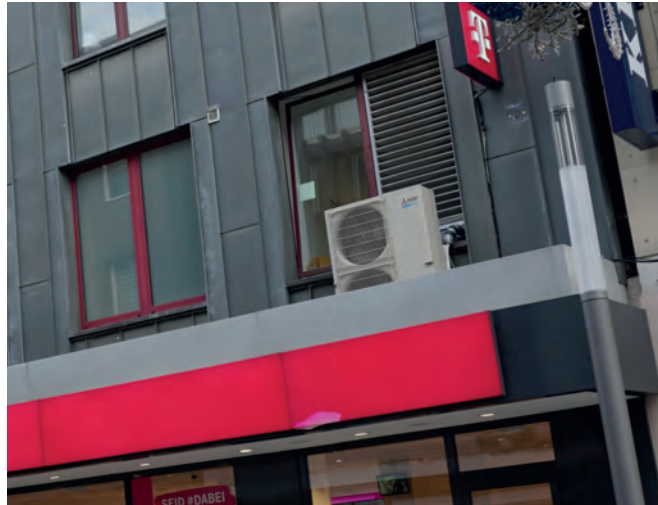
Abb. 209: haustechnische Anlagen ohne Integration in Fassadengestaltung
