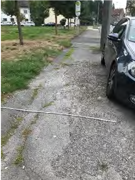
Bild 52: Beispiel für Unebenheiten auf dem Gehweg durch Schäden an der Oberflächenbeschaffenheit an der Marienstraße (Foto: IGS mbH)
