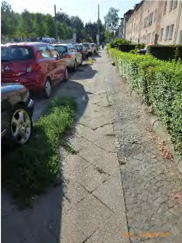
Bild 25: Unebener Gehweg auf der Marienstraße (Foto: IGS mbH)
