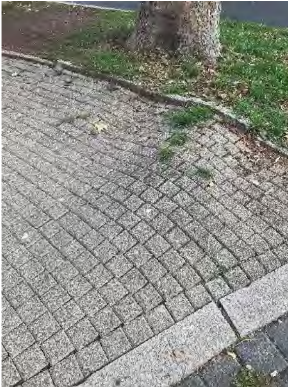
Bild 14: Unebenheiten auf dem Gehweg Westenfelder Straße (Foto: IGS mbH)
