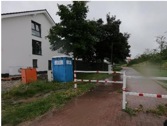
Umlaufsperrern Dietrich-Benking-Straße, Bochum
