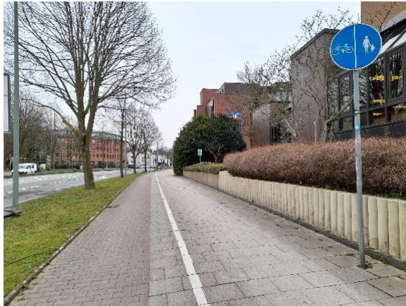
Defizite in baulicher Ausführung und Markierung Universitätsstraße, Bochum
