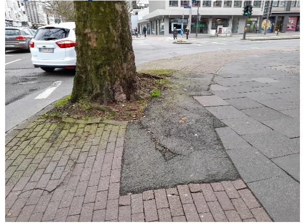
Oberflächenschaden und Baumbewuchs – Südring/ Ecke Viktoriastraße, Bochum
